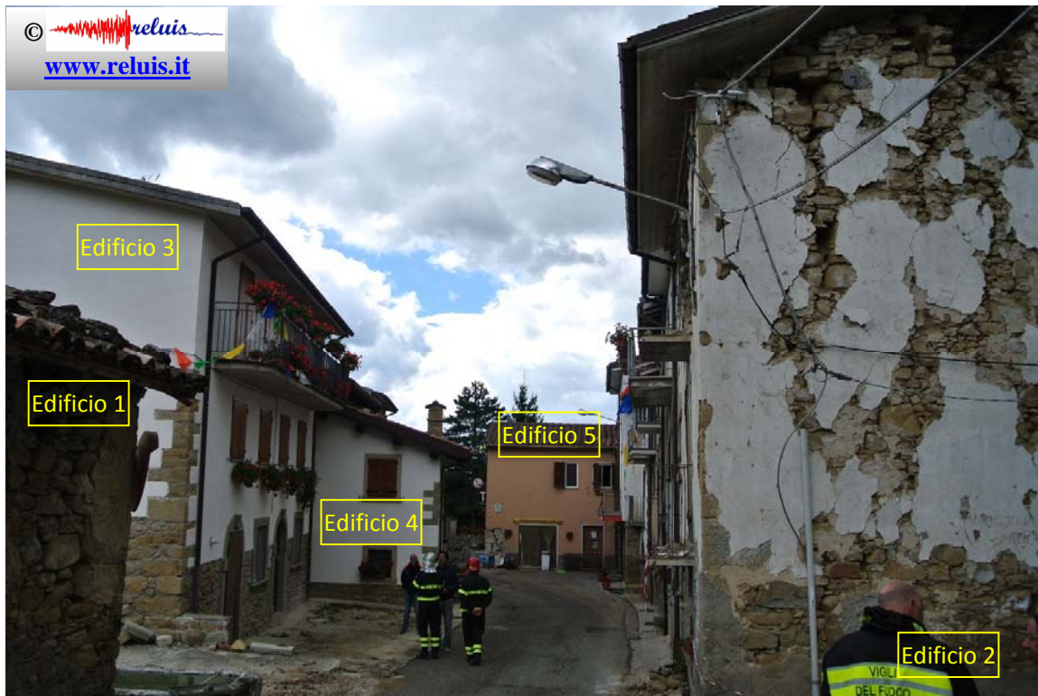
SP20–Cossara: Stato di danno degli edifici adiacenti la SP20.
