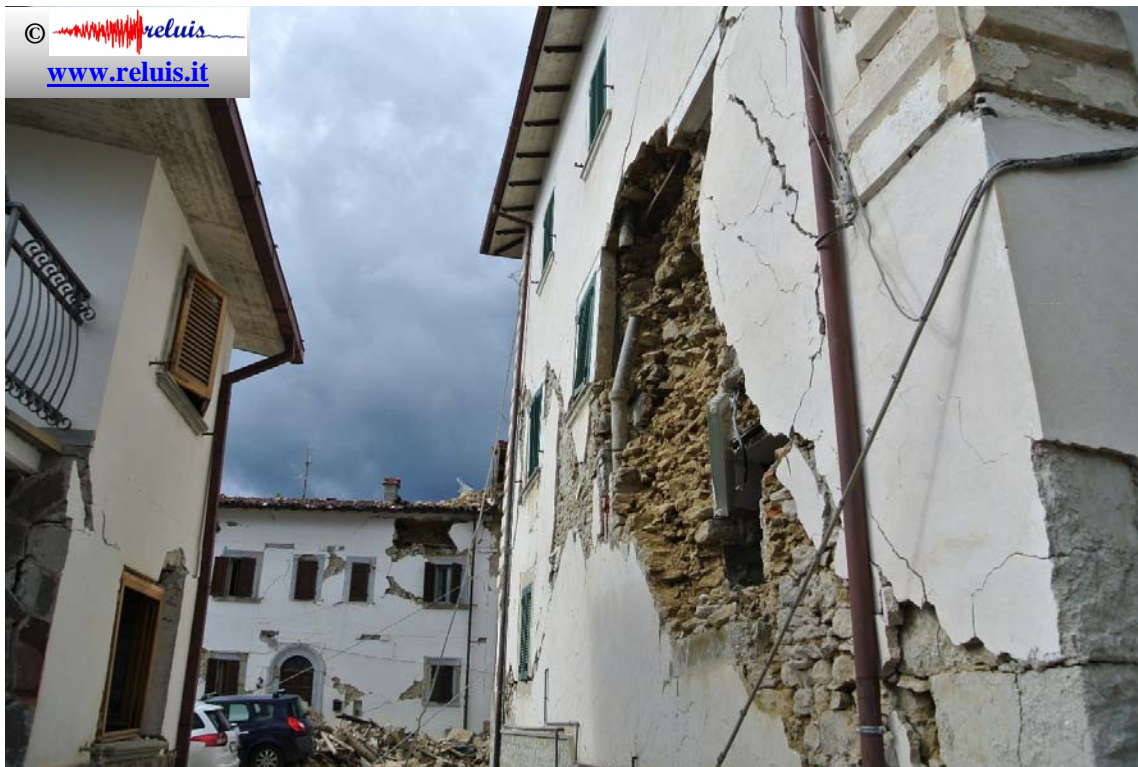
SP20 – Rio: lesioni diagonali e disgregazione della parete di facciata (Edificio 1).
