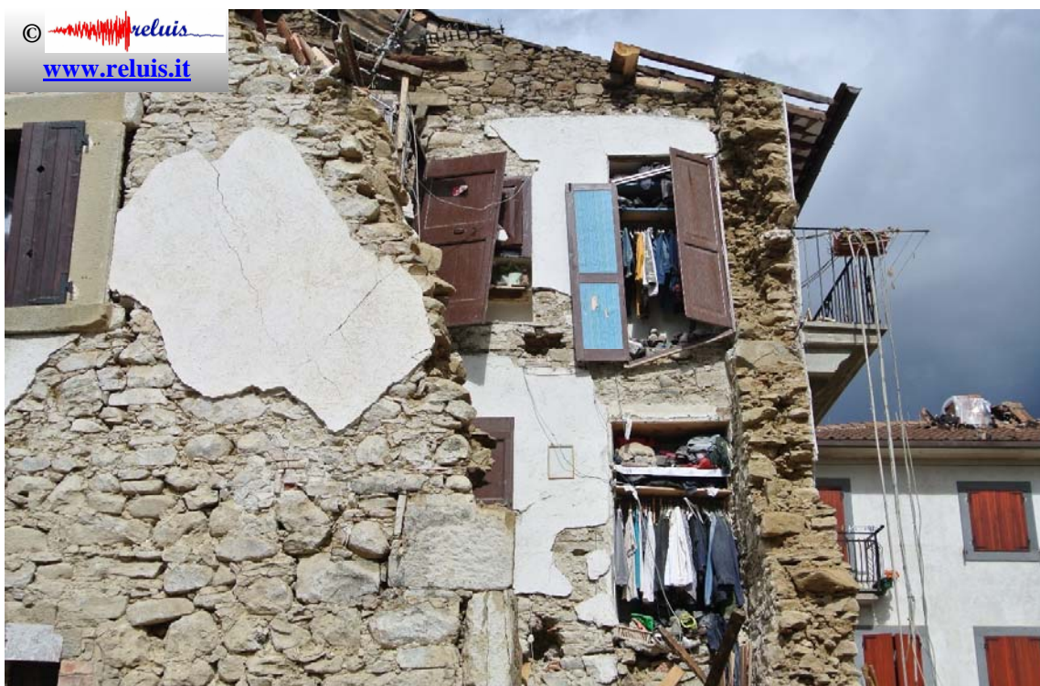
SP20 – Rio: Parziale collasso dell'Edificio 2.
