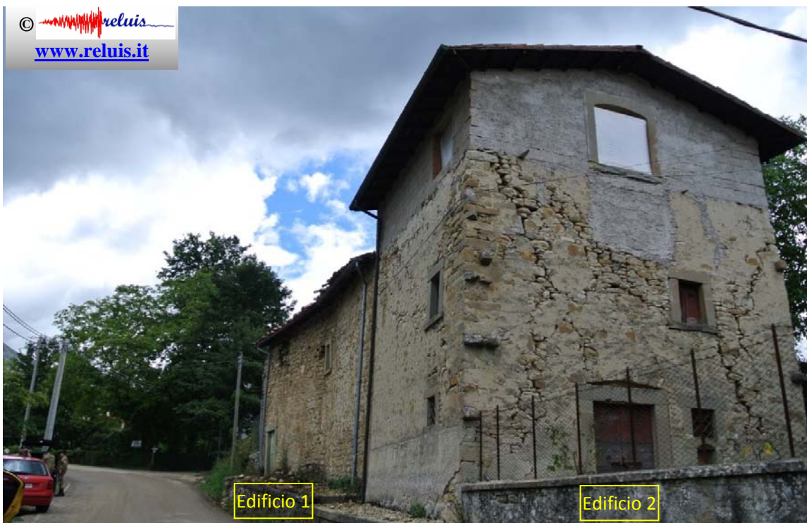
SP20–Cossara: Stato di danno di edifici adiacenti la SP20: marcate lesioni diagonali nel piano per taglio-trazione.
