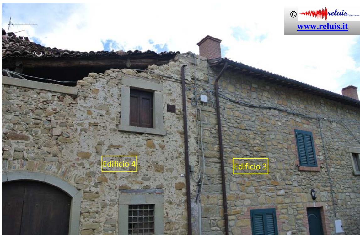
SP20–Cascello: Assenza di danni (Edificio 3); Collasso della copertura e della parte superiore della parete di facciata (Edificio 4).
