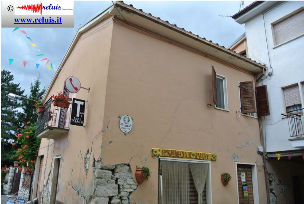
SP20–Cossara: Meccanismo di danneggiamento a taglio nel piano con espulsione del cantonale (Edificio 5).
