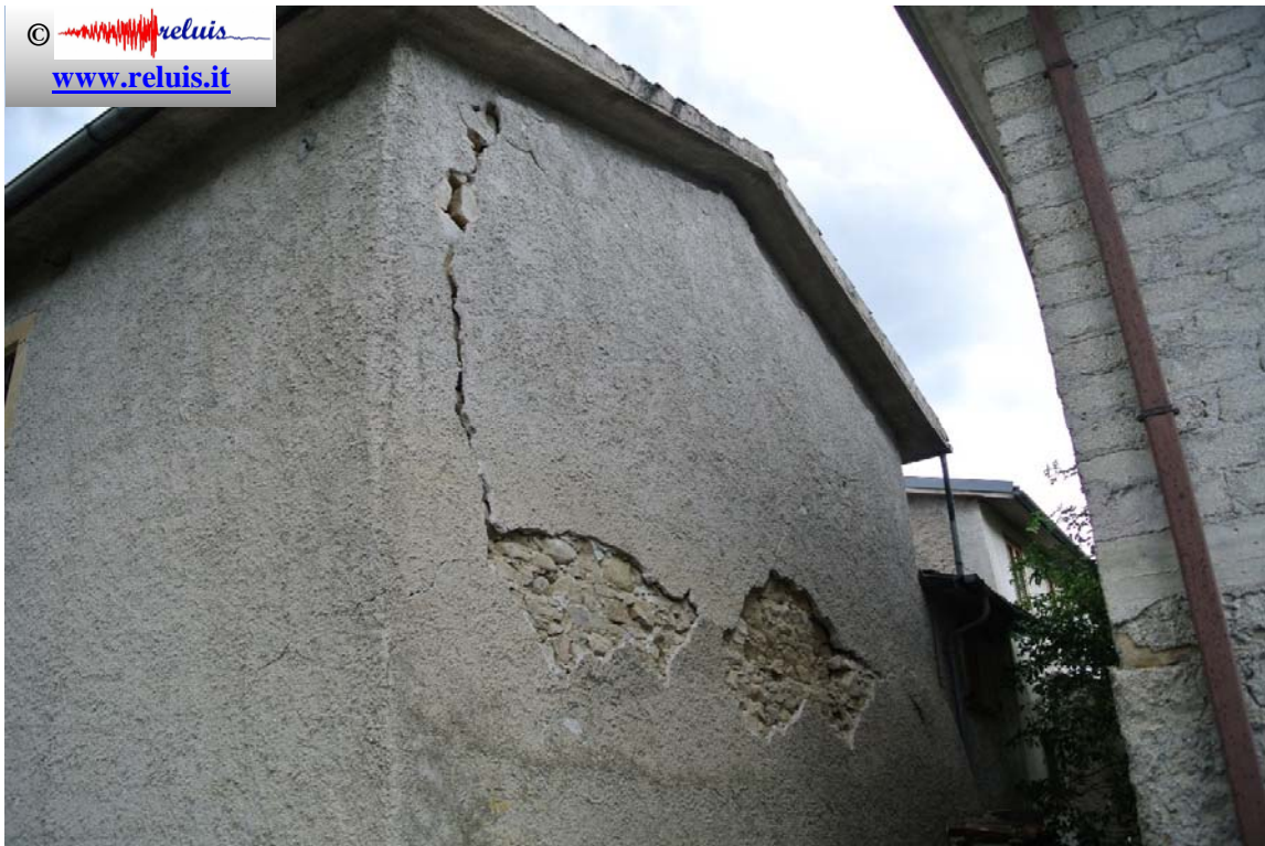
SP20–Moletano: Quadro fessurativo del retro della chiesa adiacente alla SP20
