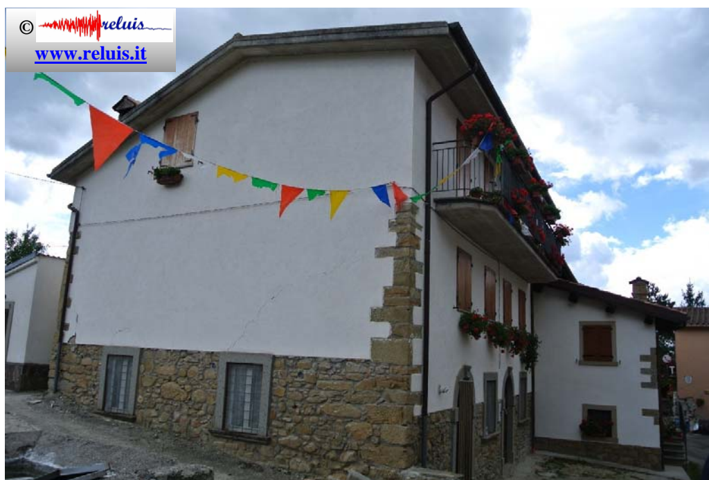
SP20–Cossara: Evidenza di fessure di piccola entità su fabbricati restaurati nel 1991 (Edifici 3 e 4).
