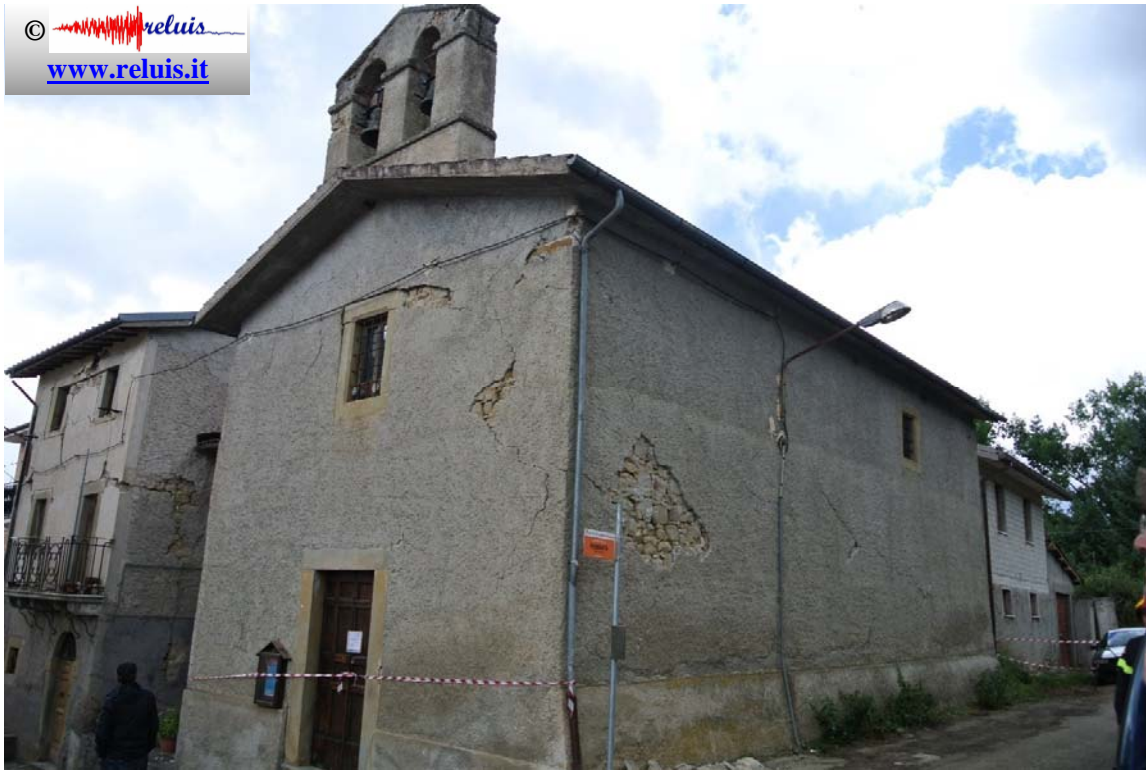
SP20–Moletano: Stato di danno della chiesa adiacente alla SP20
