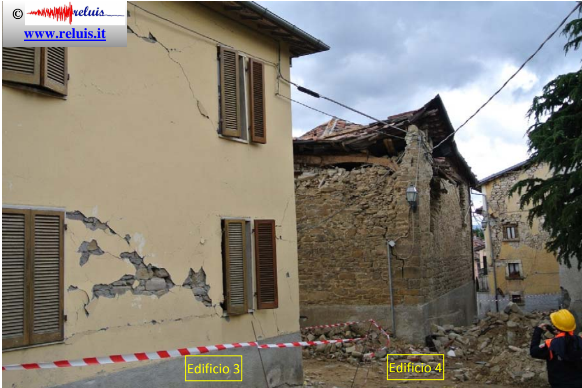
SP20–Cossara: Stato di danno di edifici adiacenti la SP20: lesioni diagonali nel piano per taglio-trazione (Edificio 3) e collasso della copertura e della parete di facciata della chiesa (Edificio 4).
