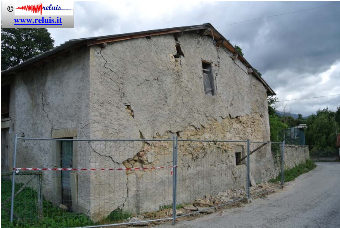
SP20–Voceto: Evidenza di fessure diagonali ed attivazione di meccanismo di ribaltamento fuori dal piano.
