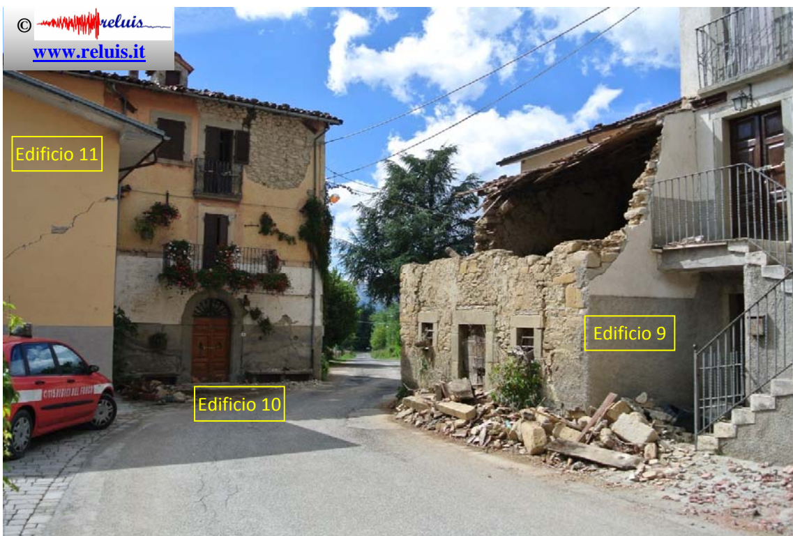
SP20–Casello: Collasso della copertura e parte superiore del fabbricato (Edificio 9); Distacchi di intonaco sulla parete di facciata (Edificio 10); Fessure diagonali (Edificio 11).
