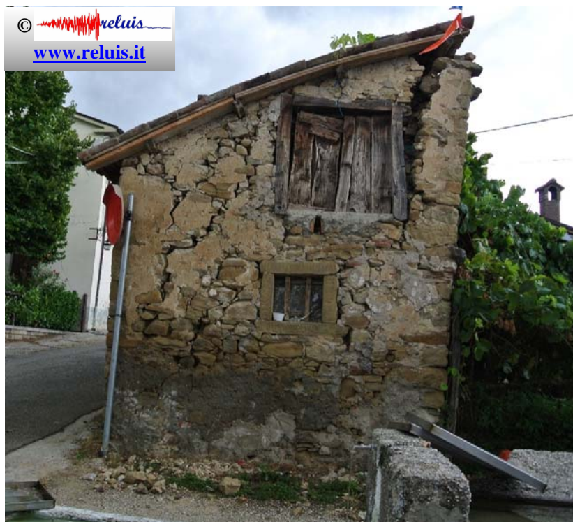
SP20–Cossara: Lesioni diagonali nel piano e meccanismo di ribaltamento fuori dal piano (Edificio 1).
