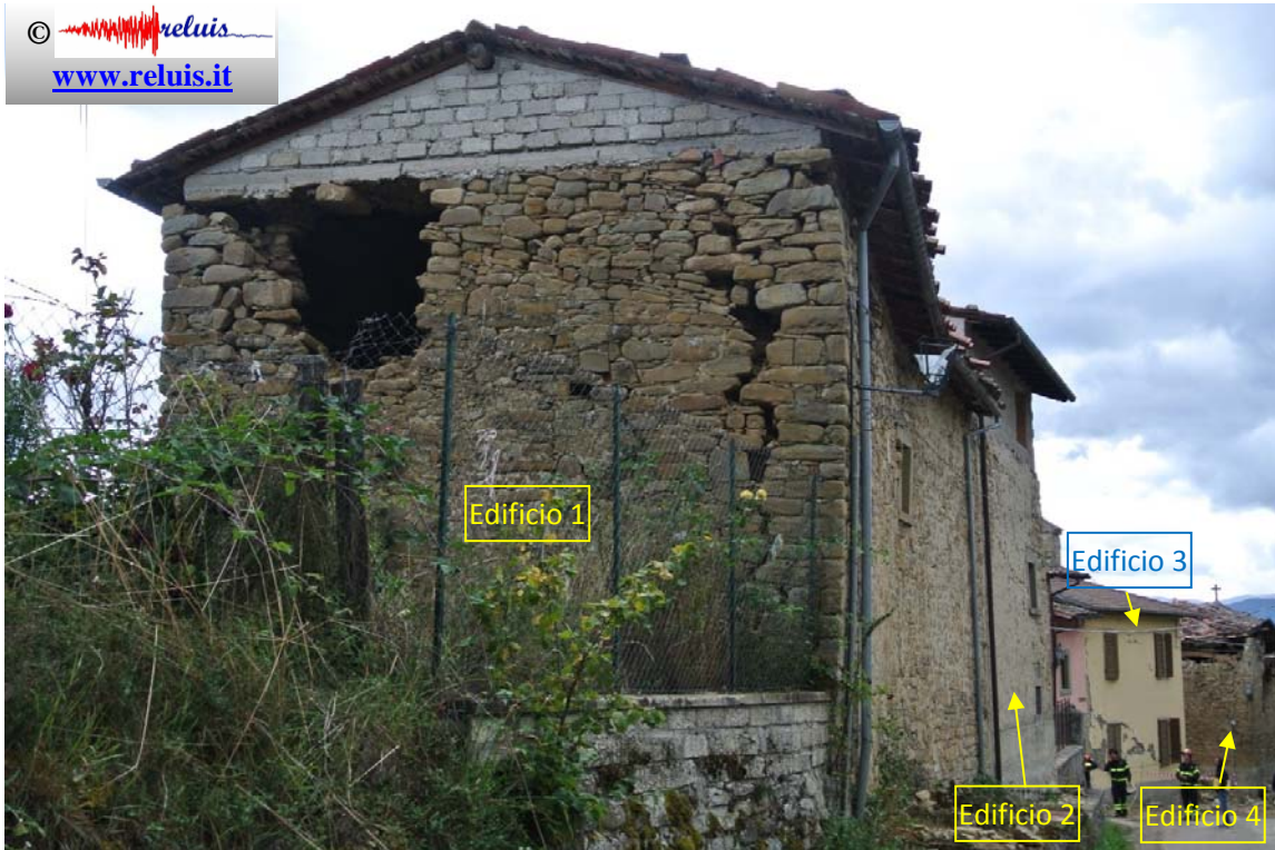
SP20–Cossara: Stato di danno di edifici adiacenti la SP20: vista dalla parte alta della strada.
