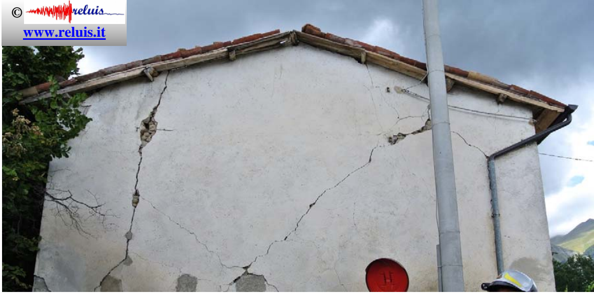
SP20–Moletano: Evidenza di fessure diagonali su edificio adiacente alla SP20.
