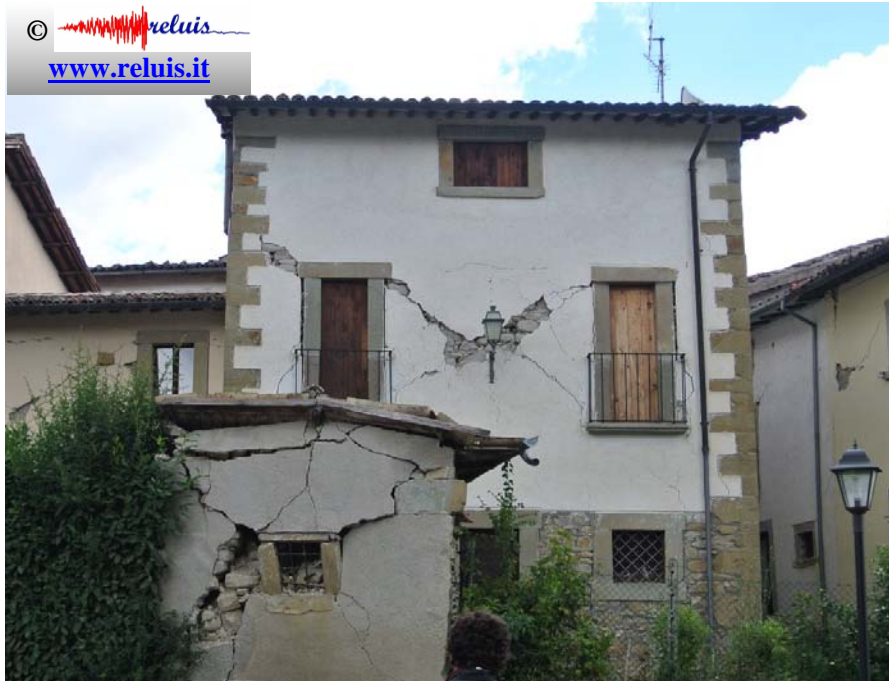
SP20–Retrosi: Evidenza di lesioni diagonali nel piano per taglio-trazione.
