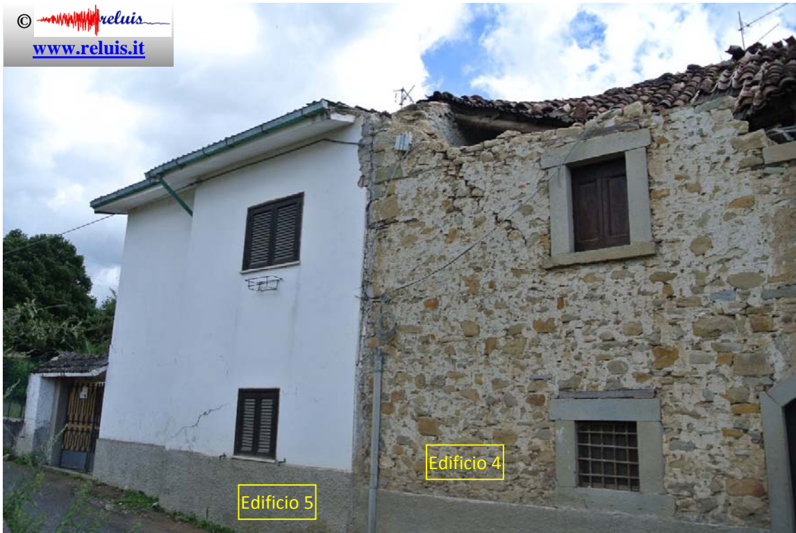
SP20–Casello: Danneggiamento (Edificio 4); Lievi fessure diagonali (Edificio 5).
