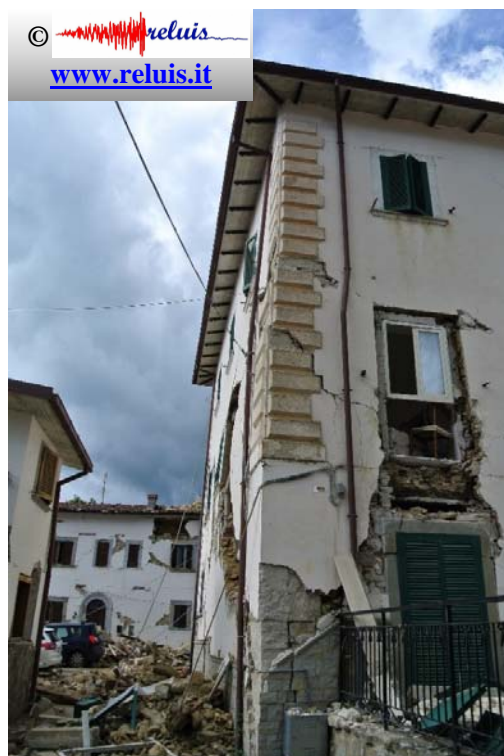
SP20 – Rio: Evidenza di lesioni diagonali e perdita di verticalità del fabbricato a partire dal primo piano (Edificio 1)
